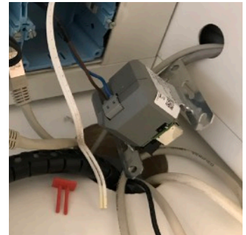
Die 100Mbps Netzwerk-Steckdosen wurden durch Gigabit-Version OMS 1021 GIG ersetzt
