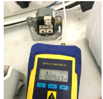
Das POF Kabel wurde neu geschnitten. Die leichte Verformung der Enden hatte keinen Einfluss auf die optische Leistung
