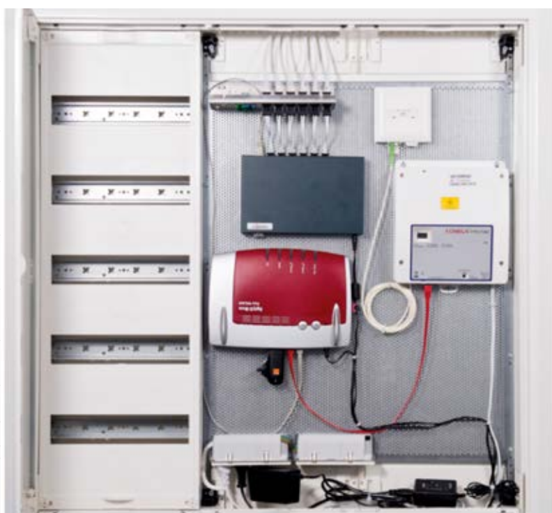
Exemple de tableau de distribution avec appareils de télécommunication
