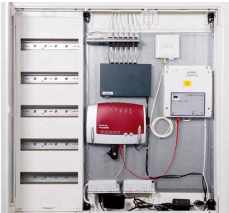
Beispiel eines Verteilkastens mit Telekommunikationsgeräten
