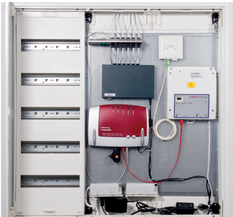
Beispiel eines Verteilkastens mit Telekommunikationsgeräten
